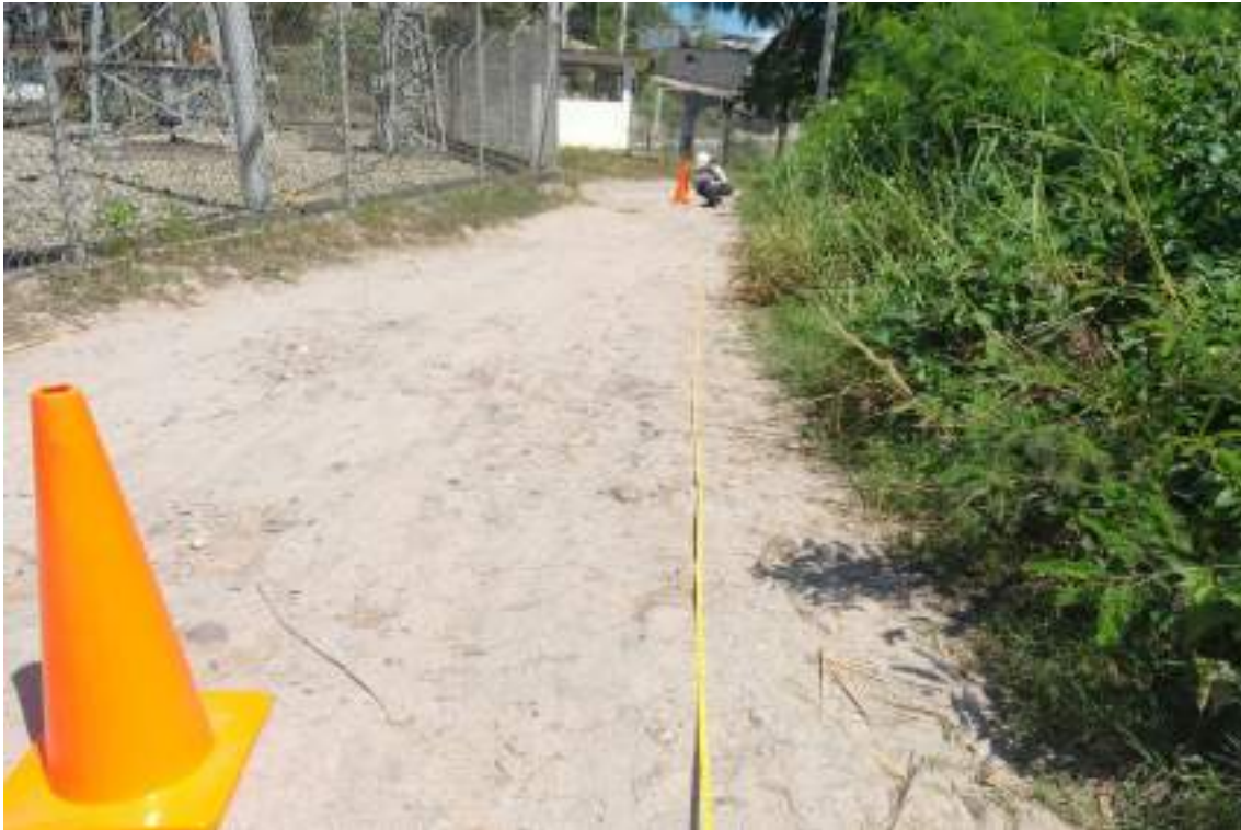
Figura 96. Pavimento deteriorado en su totalidad por presencia de fallas por huecos, desprendimientos y agregado pulido en la muestra adicional tres.
