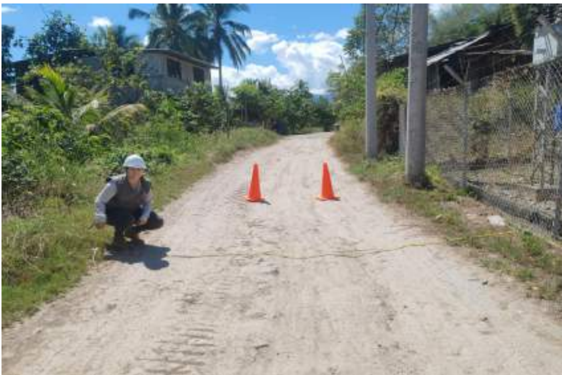
Figura 95. Pavimento deteriorado en su totalidad por presencia de fallas por huecos, desprendimientos y agregado pulido en la muestra adicional uno.
