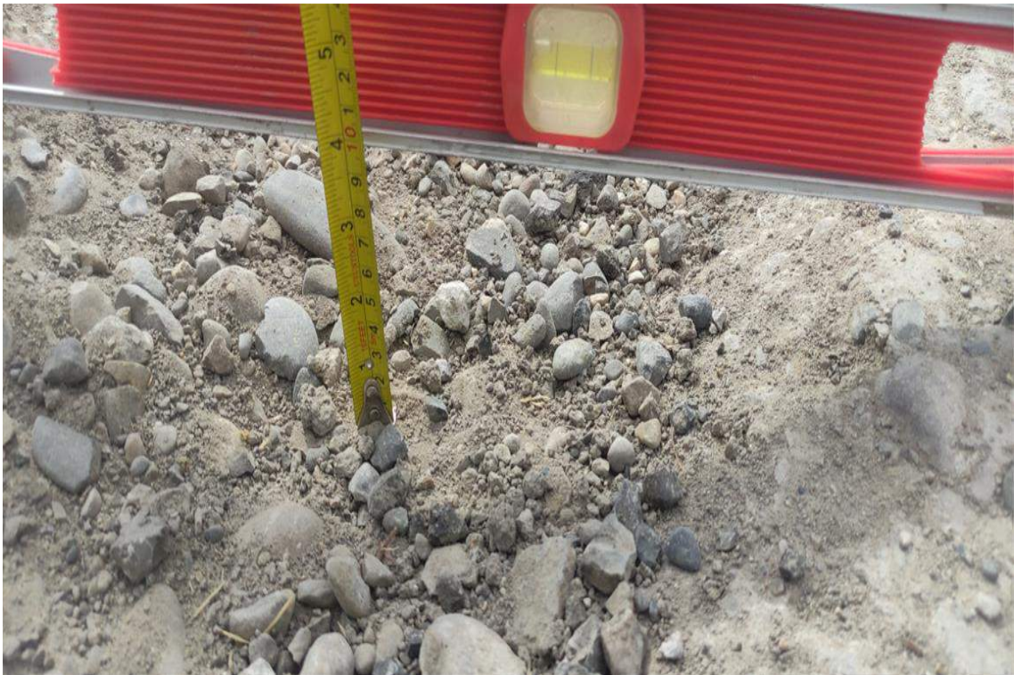
Figura 82. Falla denominada "huecos" en la muestra uno con 10 cm de profundidad considerado como falla de nivel severo.
