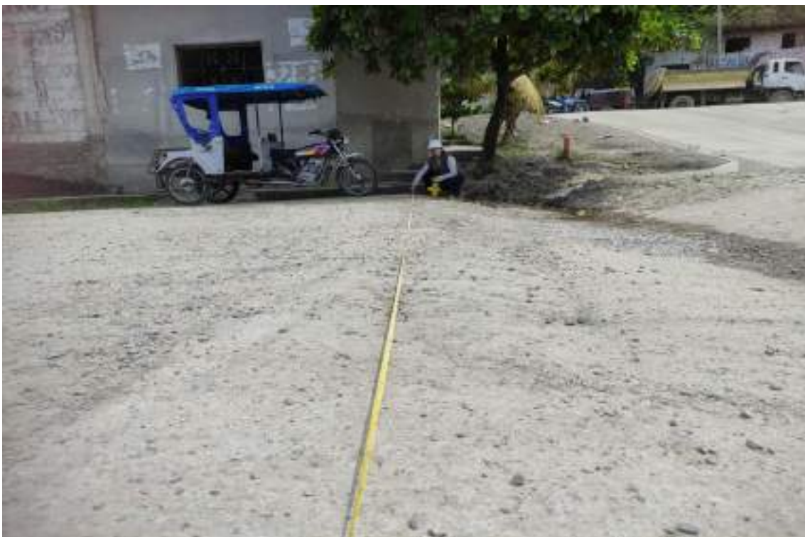
Figura 87. Falla de desprendimiento en la muestra número seis.
