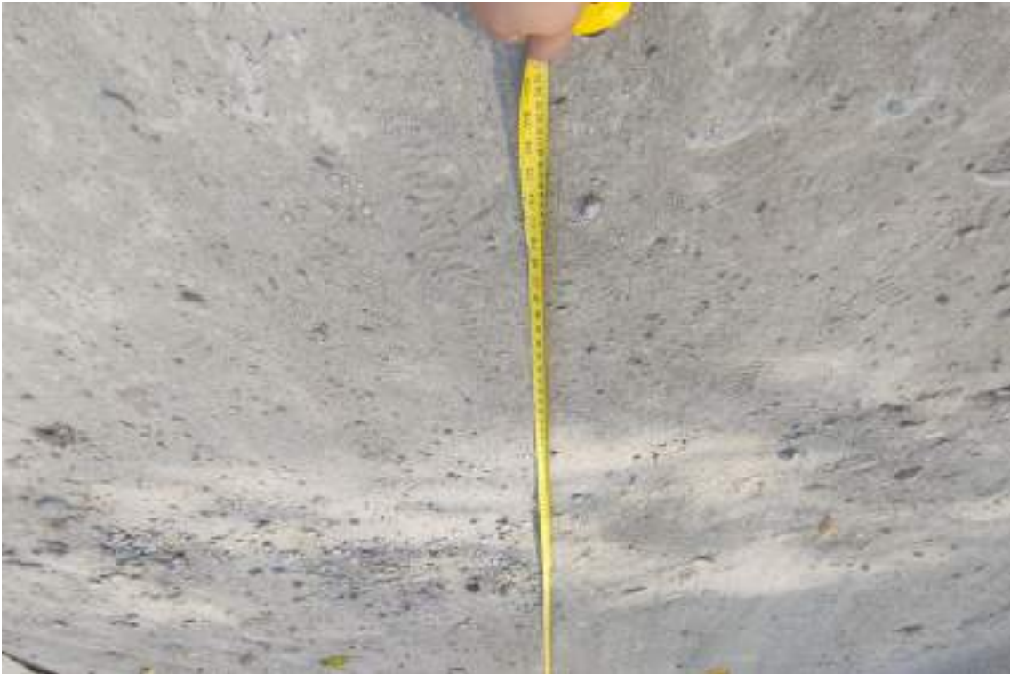
Figura 92. Falla por desprendimiento en la muestra número once.
