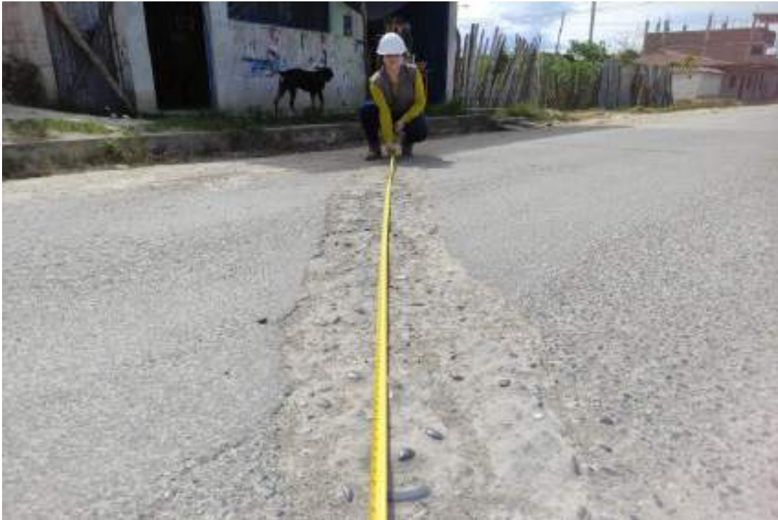
Figura 90. Falla denominada "hueco" en la muestra número nueve.
