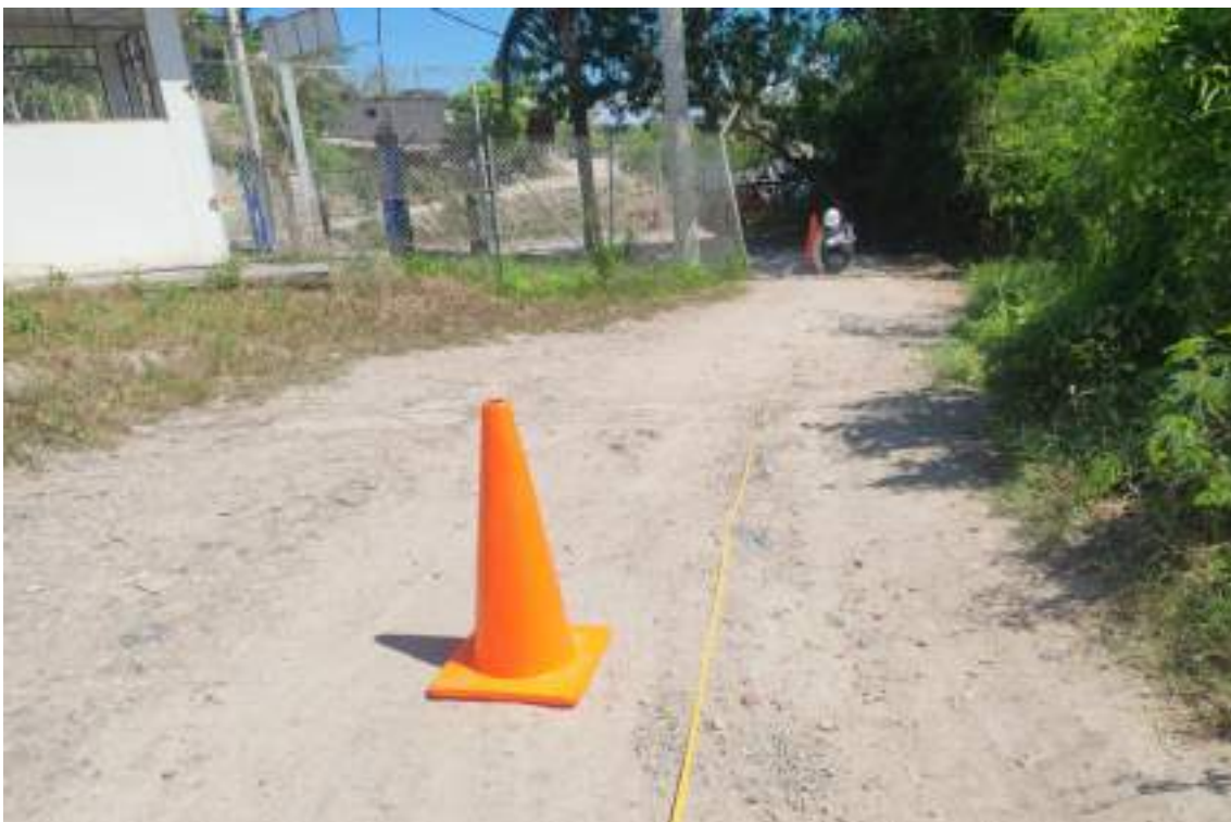
Figura 97. Pavimento deteriorado en su totalidad por presencia de fallas por huecos, desprendimientos y agregado pulido en la muestra adicional cuatro.
