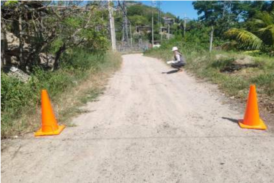
Figura 94. Pavimento deteriorado en su totalidad por presencia de fallas por huecos, desprendimientos y agregado pulido en la muestra adicional uno.
