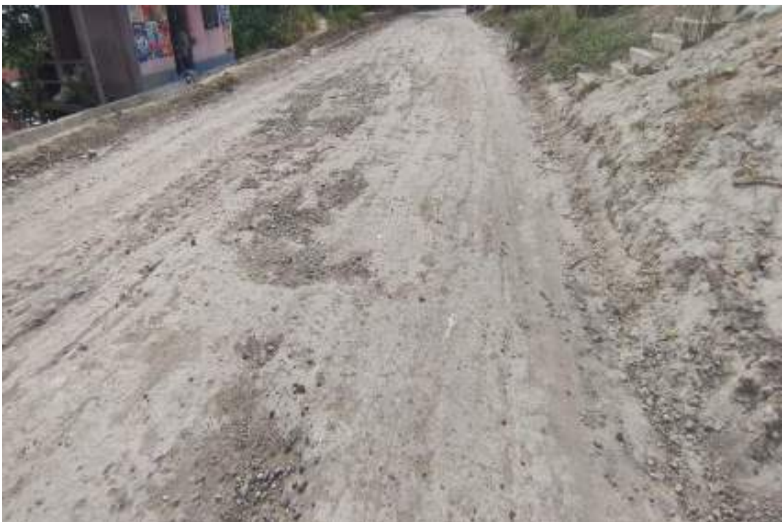
Figura 83. Pavimento fallado en su totalidad por presencia de huecos, desprendimiento, y agregado pulido.
